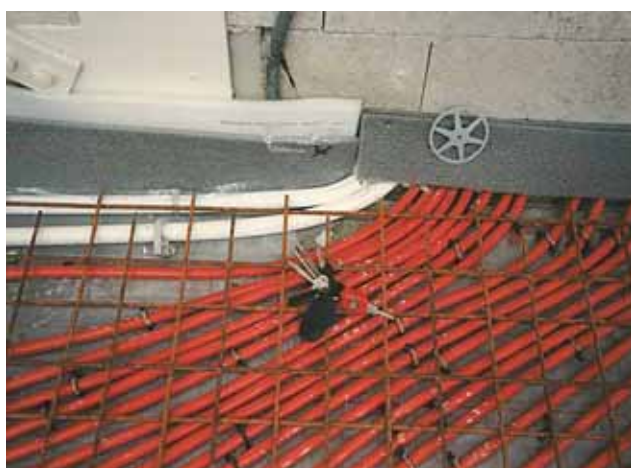
Voorkomen van leidingconcentraties in betonvloeren.
