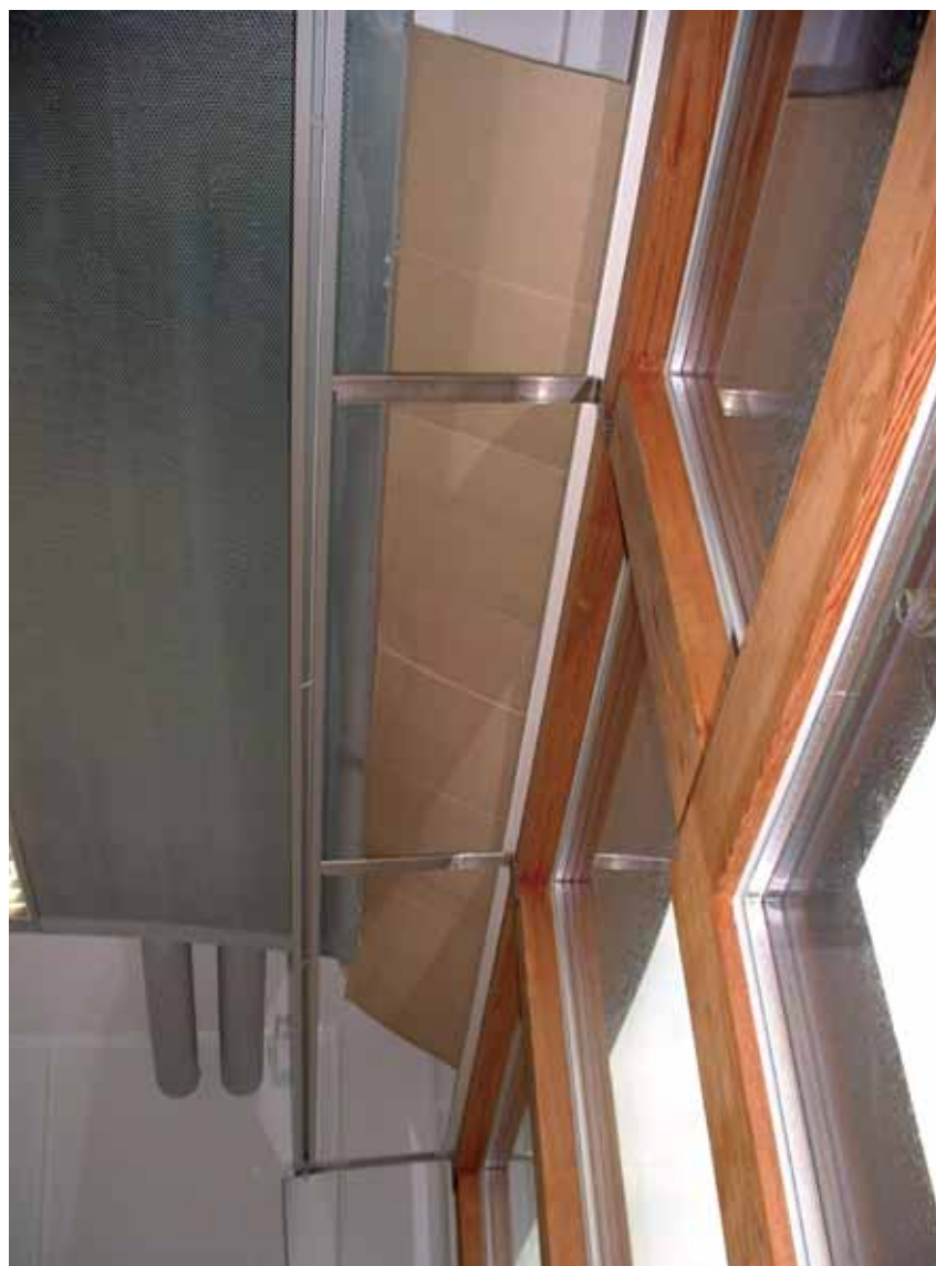
Ter voorkomen van koudeval is een schot geplaatst.
