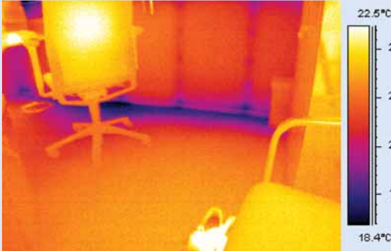
Infraroodopname van de aansluiting van de gevel en de vloer.
