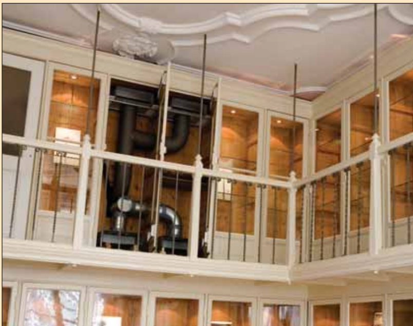
Een goed voorbeeld van de toepassing van de vloerunit. In deze monumentale kamer is de unit weggewerkt in een kast.
