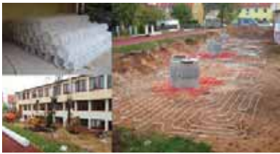
De bodemwarmtewisselaar met 9 meter diepe aardsonden met een diameter van 50 cm. en volgestort met beton en een grondbedekking van 1,5 meter [27].
