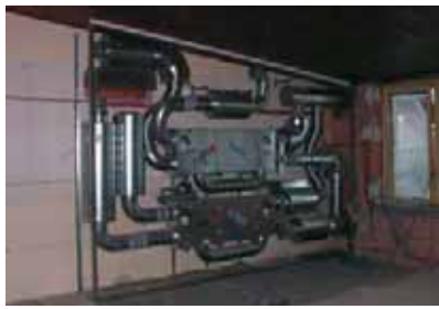
Decentraal ventilatie systeem in tussenwand gemonteerd in het klaslokaal [26].
