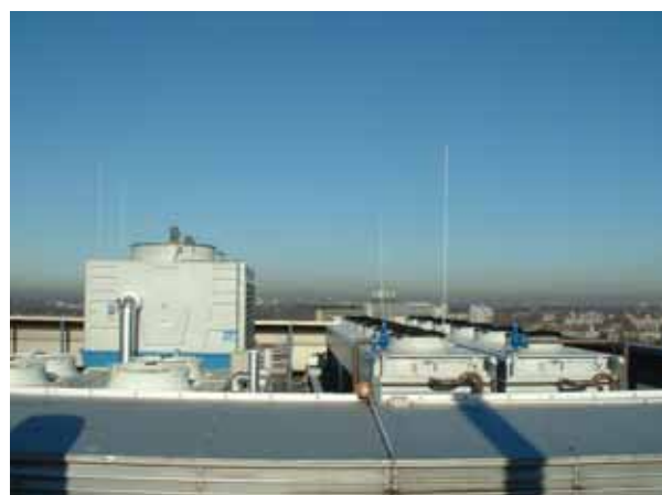
Opstelling op het dak met links de tot vrije koeler omgebouwde condensor.
