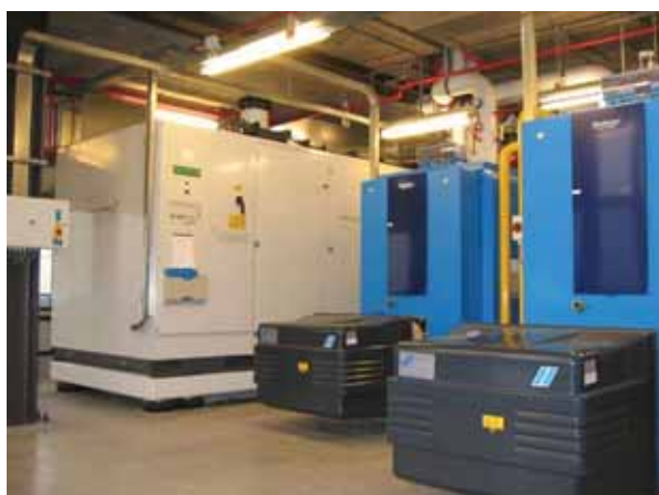
De nieuwe ketels en de WKK.
