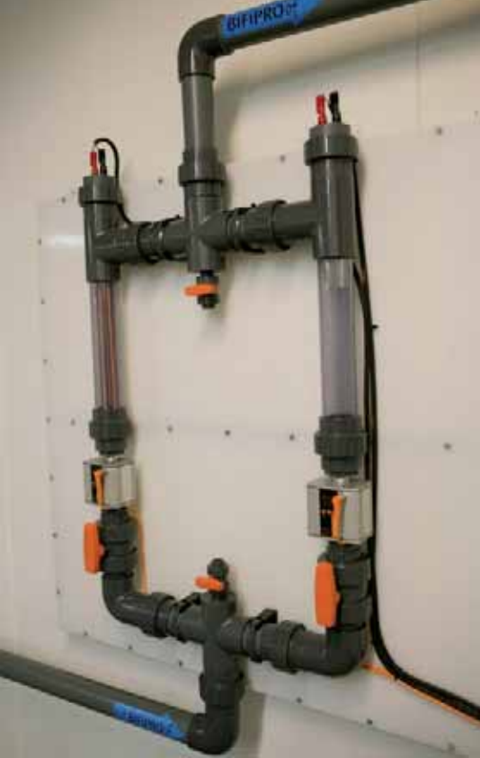
Het water stroomt langs de koper- en zilverstaven het gebouw binnen.
