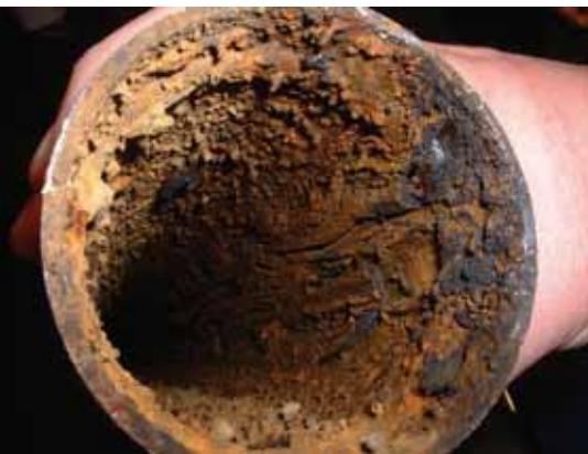
Het zal duidelijk zijn dat de aangroei in de buis op de afbeelding een zeer negatieve invloed heeft op de leidingweerstand waardoor een sprinklerinstallatie niet doet wat van de installatie wordt verwacht.
