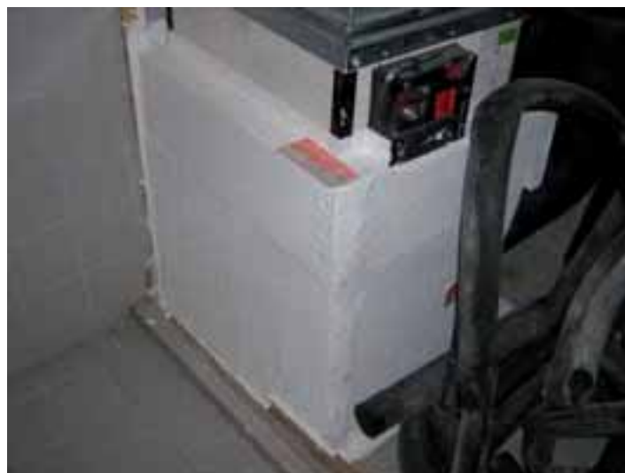
Brandklep op afstand geplaatst. Het gedeelte tussen vloer en het kleppenblad in de brandklep is brandwerend geïsoleerd met steenwolafdichtingsplaten.
