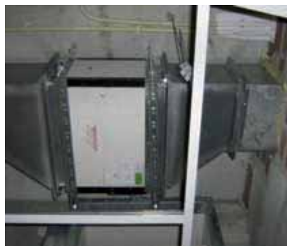
Brandklep op afstand geplaatst. De wand rechts vormt de brandscheiding. Tussen wand en klep is geen brandwerende bekleding voorzien. De klep is bovendien verkeerd om geplaatst.
