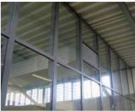
Beëindiging kanaal in stalen pui met glas van ca. 6 m hoog. De brandklep is op ca. 2 m van deze pui voorzien. Het gedeelte van het kanaal tussen de brandklep en de pui is brandwerend geïsoleerd. Ventilatiekanaal zal vervorming van stalen pui niet kunnen volgen bij brand.
