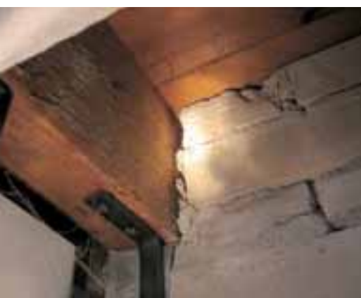
Onvoldoende brandwerendheid ter plaatse van aansluiting dakgording op bouwmuur.
