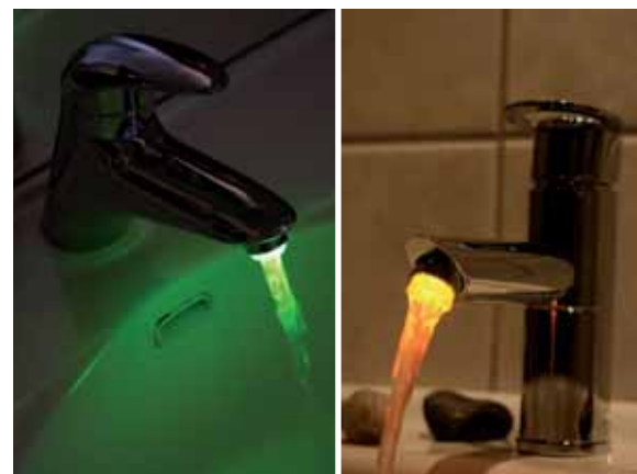
Wastafelkranen voorzien van een opzetstuk met LED-verlichting.
