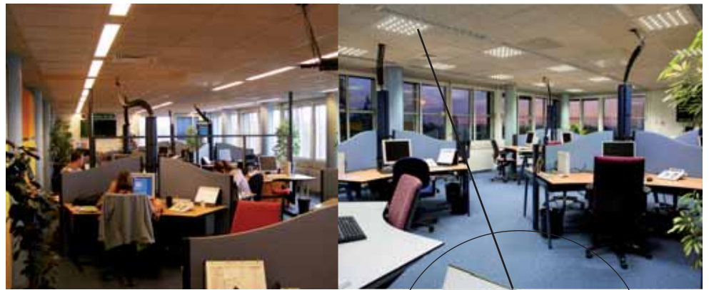
Vergelijk situatie kantoor voor en na plaatsing LED-verlichting.
