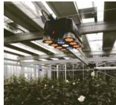
LED verlichting in de kassenbouw [7].
