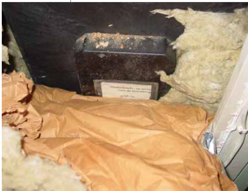
Weggebouwde mechanische installatie.
