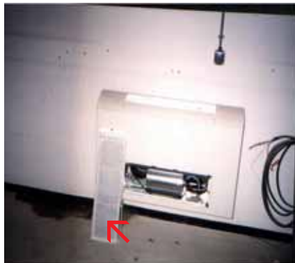
Voorbeeld van onderhoud vooral op techniek gericht: filters van convectorunits worden zelden vervangen - Foto 6 -
