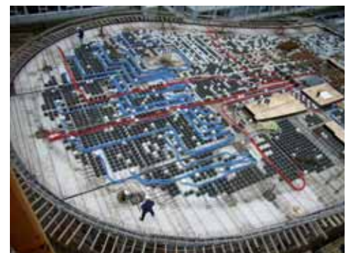
Leidingen ten behoeve van vloeractivering.
