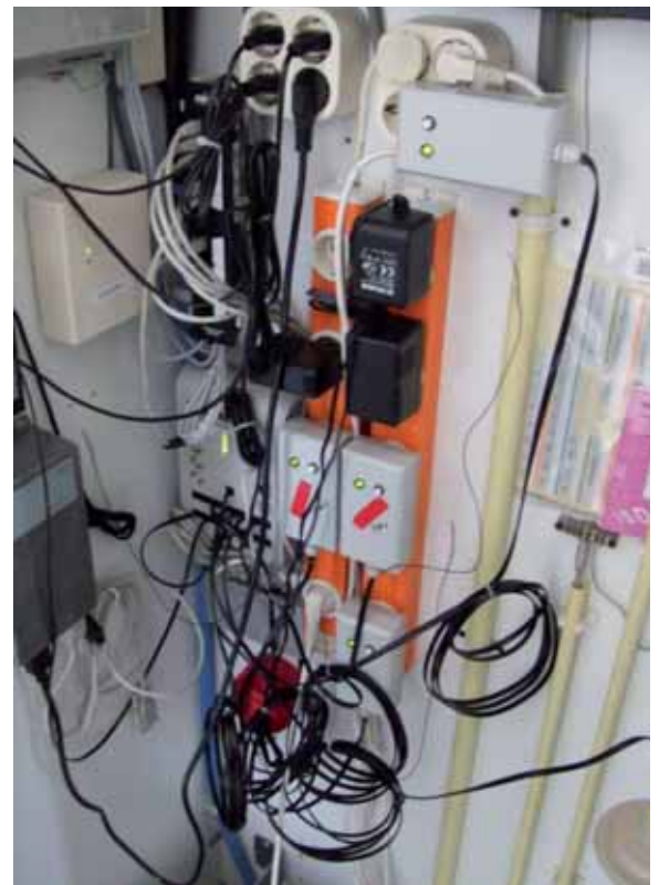
De installatie van domotica vraagt om extra ruimte in de meterkast, zoals in deze demonstratiewoning in Bodegraven.
