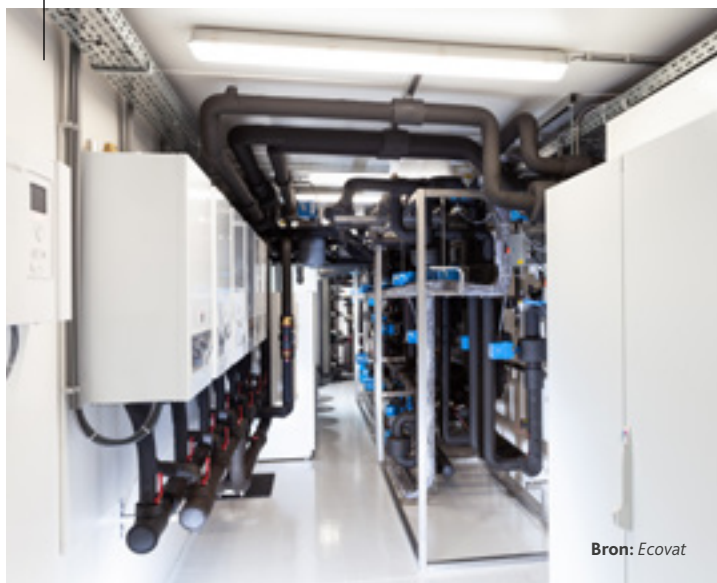
Foto 2: Het interieur van de container van de andere kant. Links de elektrische weerstandsketels.
