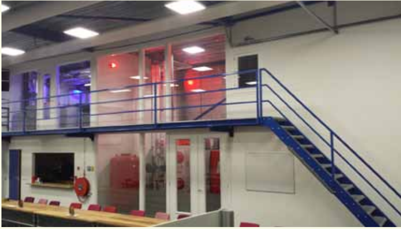
-Figuur 6- Realisatie. Van linksboven naar rechtsonder: warmtepompkamer blauw verlicht, hout-cv-ruimte rood verlicht, inspectieluik houtsnipperbunker, pantry met daarachter toiletten; alles transparant aangrenzend aan een multifunctionele ruimte (hoofdzakelijk conference room).
