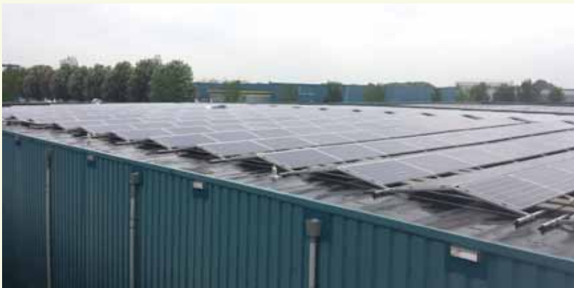
-Figuur 7- Het dak met pv-cellen
