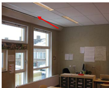
-Figuur 5- Praktijkonderzoek tocht risico. Aanzicht suskast en convectorbuis in spoiler (linksboven), hoogte luchtspleet is instelbaar (rechtsboven) en aanzicht interieur leslokaal met weergave spoiler ter plaatse van gevel (onder)
