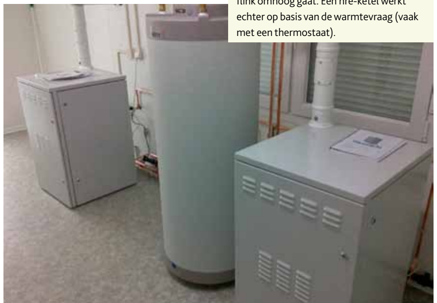
-Foto 1- een I-Balance opstelling van twee SOFC-brandstofcellen i.c.m. een (warmte)buffervat. De SOFCs zijn zo groot als een tafelmodel koelkast.
