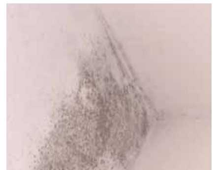
-Figuur 1- Schimmelgroei bij een aansluiting van een binnenwand met een buitenwand voorzien van binnenisolatie
