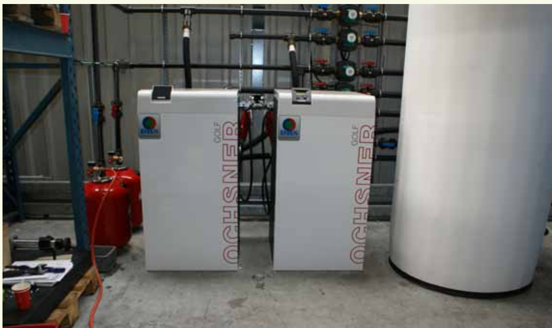
-Figuur 3- Opstelling warmtepompen
