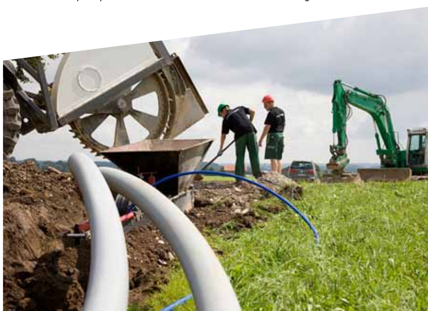
Aanleg van flexibele warmteleidingen van een wkk op biogas bij een boerderij naar gebruikers (bron Rehau)
