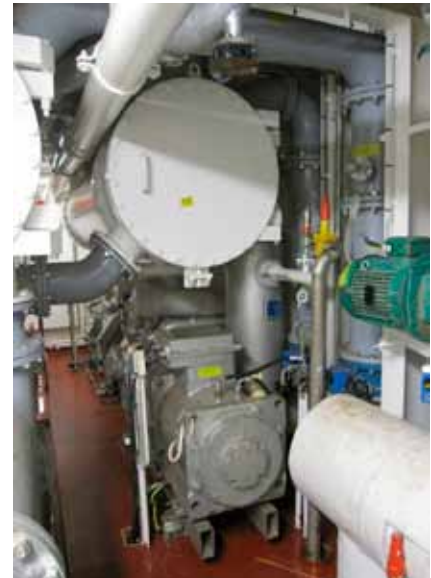
-Figuur 2- Een koeltechnische compressor met aansluitend koeltechnisch leidingwerk
