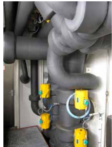
-Figuur 3- Een aan boord gesitueerd koelwater leidingwerk met isolatie en vlinderkleppen met standmelders. Het systeem werkt volautomatisch op een eigen besturingsprogramma, maar kan via operators handmatig worden overgenomen.
