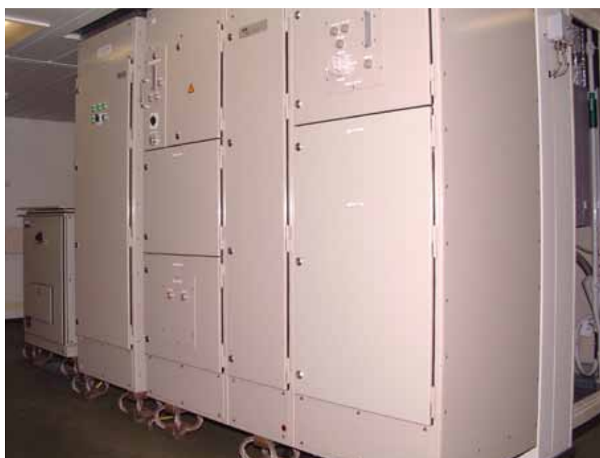
-Figuur 1- Generator opstelling (foto Imtech Marine)
