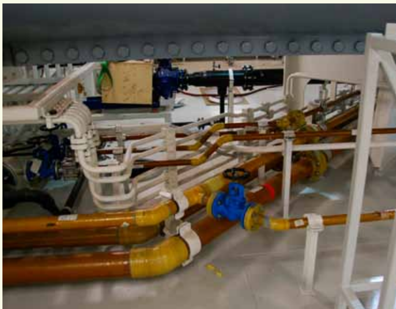
-Figuur 18- Stalen, GVK- en HPE-leidingsystemen
