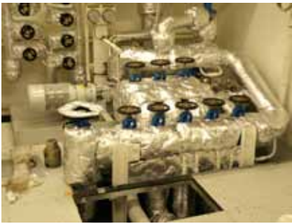
-Figuur 14- Geïsoleerde afsluiterkast
