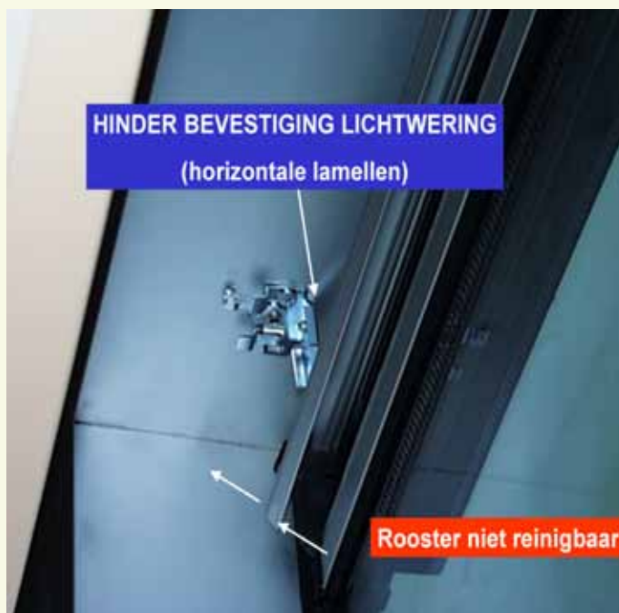
-Figuur 5- Door de bevestigingsbeugel van de lichtwering kan het rooster niet geopend worden
