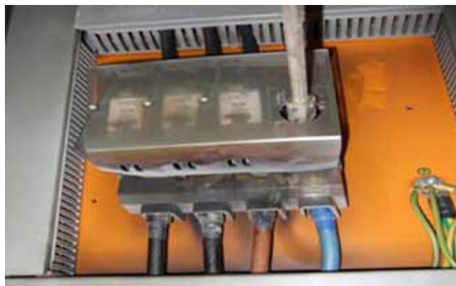
-Foto 3- Ook zonder thermografische camera is oververhitting ten gevolge van overbelasting vaak zichtbaar, voelbaar of te ruiken. Inspecteurs zijn in ons land echter niet bevoegd een installatie buiten bedrijf te stellen zonder toestemming van de eigenaar.
