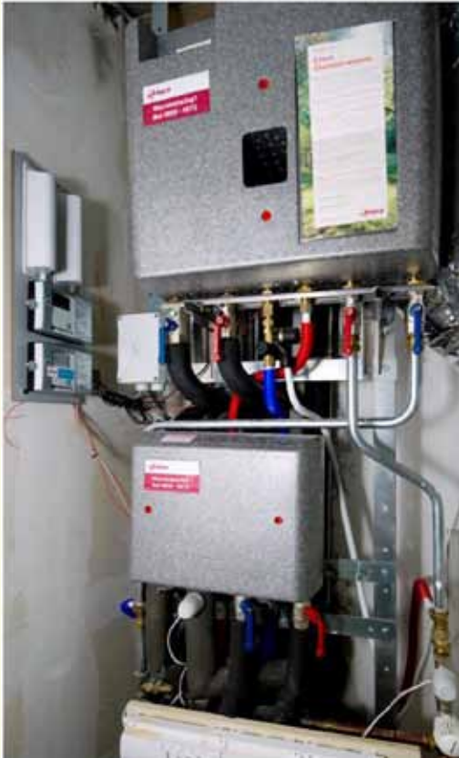
-Figuur 2- De meterkast moet voor onverhoopte storingen bereikbaar zijn
