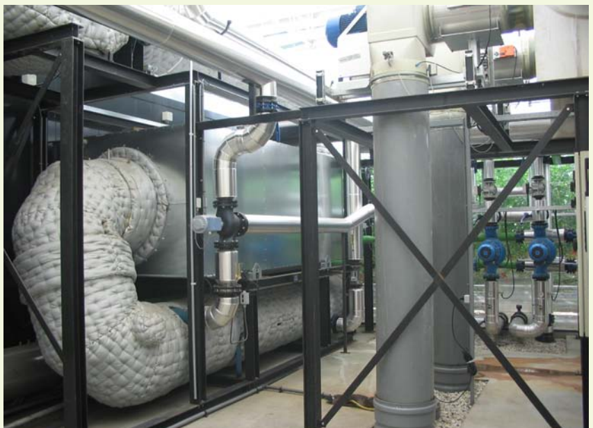
-Figuur 5- Rookgasreiniger (SCR gedeelte)
