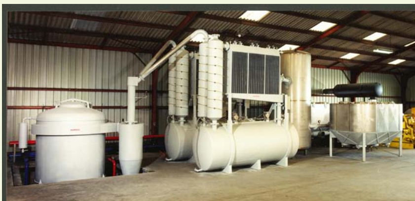
-Figuur 10- Vergasser-WKK-installatie (Martezo)
