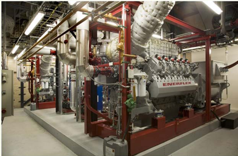
-Figuur 2- Voorbeeld van een warmte/krachtinstallatie, zoals in de tuinbouw veelvuldig wordt toegepast
