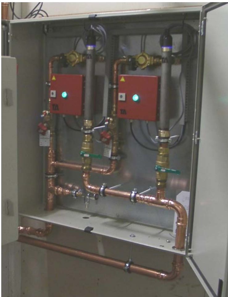
-Figuur 8- AOT-Aqua+ ingebouwd in een drinkwater installatie.
