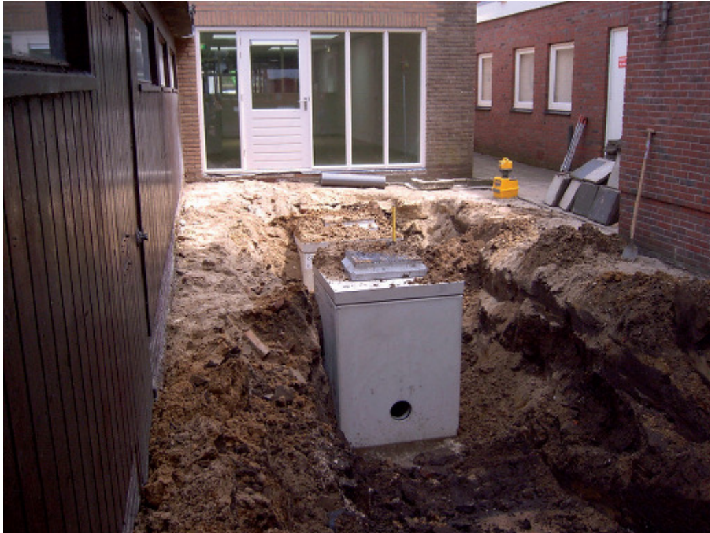
Figuur 7.2: Afbeelding twee van de vier in serie opgestelde urineopslagtanks in de achtertuin van het Ambacht Huys te Meppel. De tanks hebben elk een netto inhoud van 1\text{m}^3 , [Scheffer 2005].
