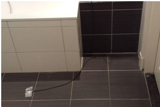
Foto 1.11 Plaatsing van de vloersensor.
