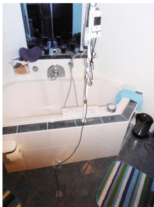
Foto 1.6 Plaatsing sensor vloertemperatuur
