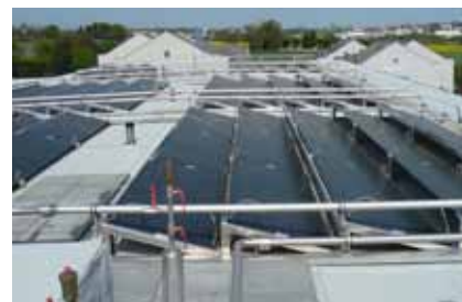
-Figuur 2- Ongeveer 1.160 m 2 onverglasde, beloopbare zonnecollectoren zijn op het dak van de woongebouwen geplaatst. Ze zijn ontworpen om ook nog energie kunnen ontwikkelen onder ongunstige omstandigheden (foto: Bösch)
