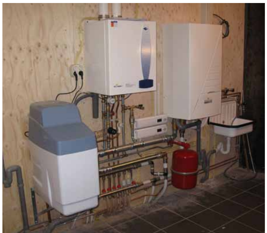
-Figuur 2- Een gedemonteerde installatie
