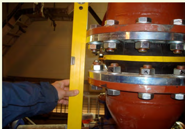
-Foto 2- Onder spanning geplaatste compensator die op den duur zal scheuren
