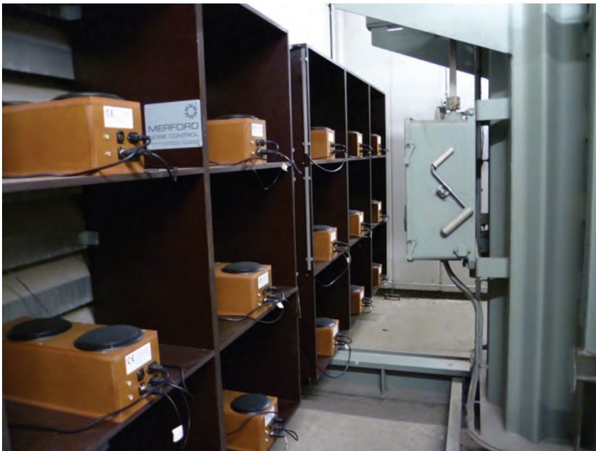
-Figuur 3- De huidige situatie in het transformatorstation van Westland Infra in Poeldijk. Het ANR-systeem is opgebouwd voor de luchtroosters.
