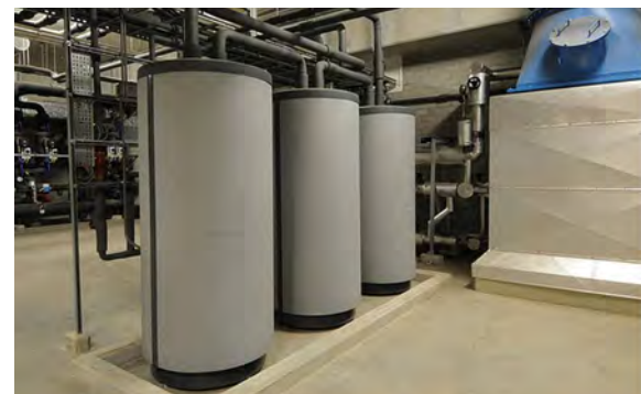
-Figuur 6- Collectieve warmtapwatervoorziening
