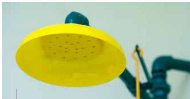
Foto 3: Nooddouches moeten worden aangesloten op de drinkwaterinstallatie.
