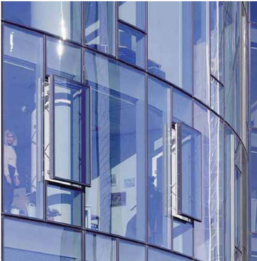
Main Tower, Frankfurt am Main, arch.: Schweger und Partner. Een geheel transparante façade kan voor gebruikers met hoogtevrees zeer onaangenaam zijn. Merk op dat de dame links in de afbeelding enige afstand bewaart ten opzichte van het glas. Door middel van de uitzetramen kunnen de gebruikers zelf invloed uitoefenen op het binnenklimaat. De klimaatinstallaties worden bij geopende ramen automatisch uitgeschakeld.
