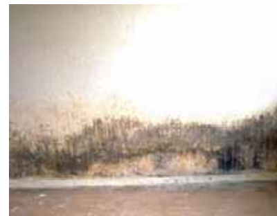
Meting is niet altijd nodig om problemen te herkennen: schimmel op een zijgevel.
