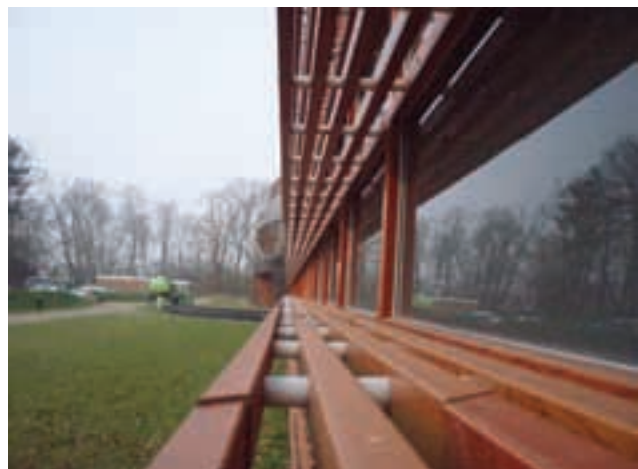
De vaste zonwering aan de zonbelaste buitengevel.
