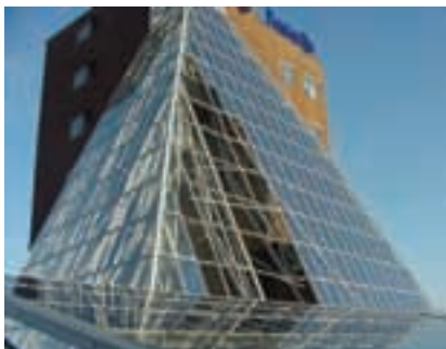
Voorbeeld van een schade als gevolg van te weinig sterkte in de dragende constructie.
