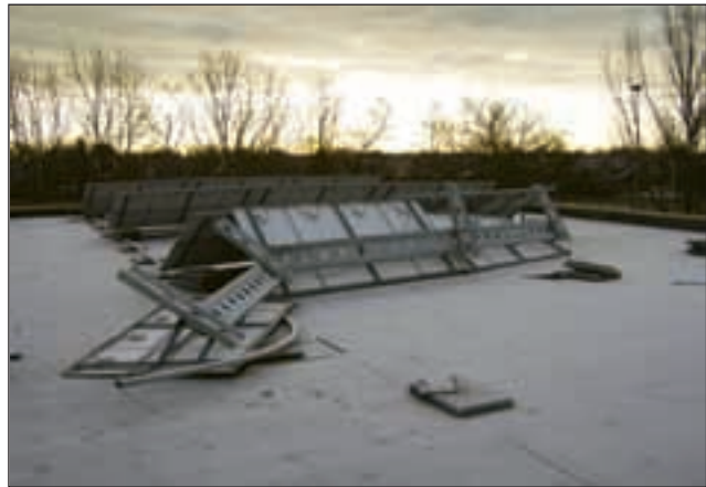
Voorbeeld van een stormschade door te weinig ballast.
