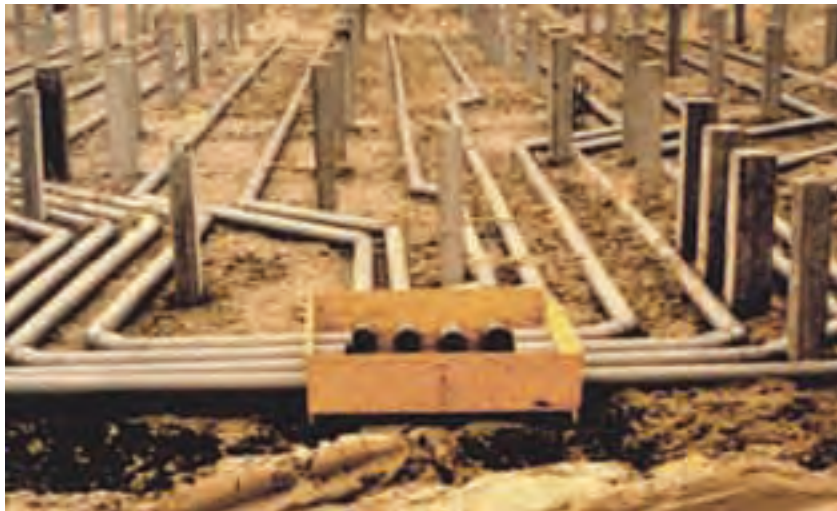
Bodemcollectoren Brandweerkazerne Deventer 1990.
