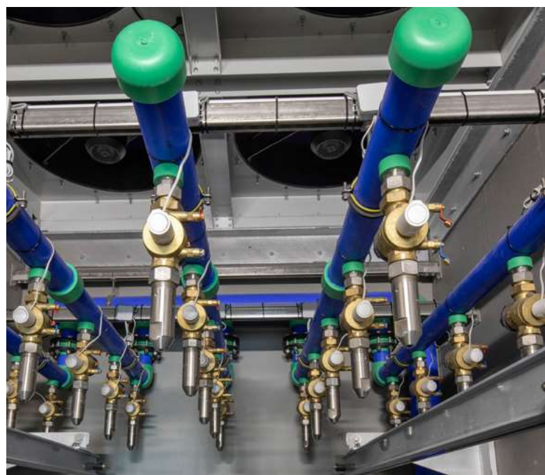
Foto 1: Klimaatcascade in het Langeveld Building van de Erasmus Universiteit Rotterdam. Ventilatiecapaciteit 67.500 m 3 /h.
